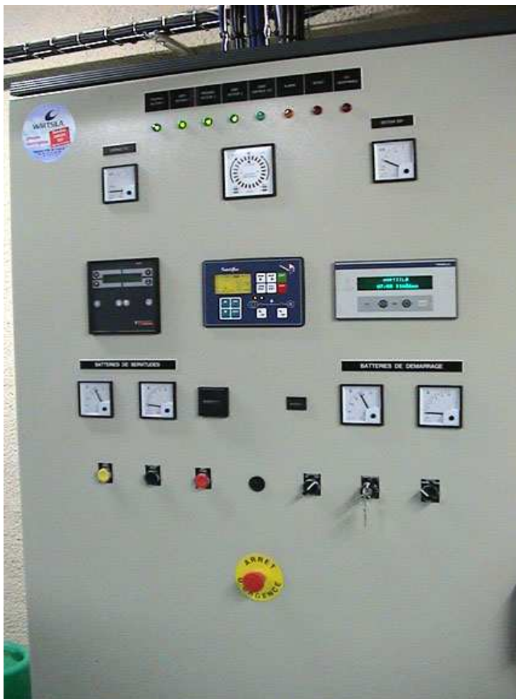
Face avant de l'armoire de contrôle commande
